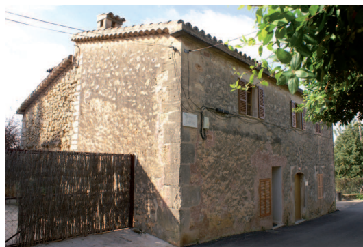
Figura 319. Ca na Blanca, calle dels Cortons nº 18. En esta vivienda se pueden apreciar las diferentes etapas constructivas. Originariamente, se trataría de un único cuerpo de una planta con cubierta inclinada hacia la calle.
