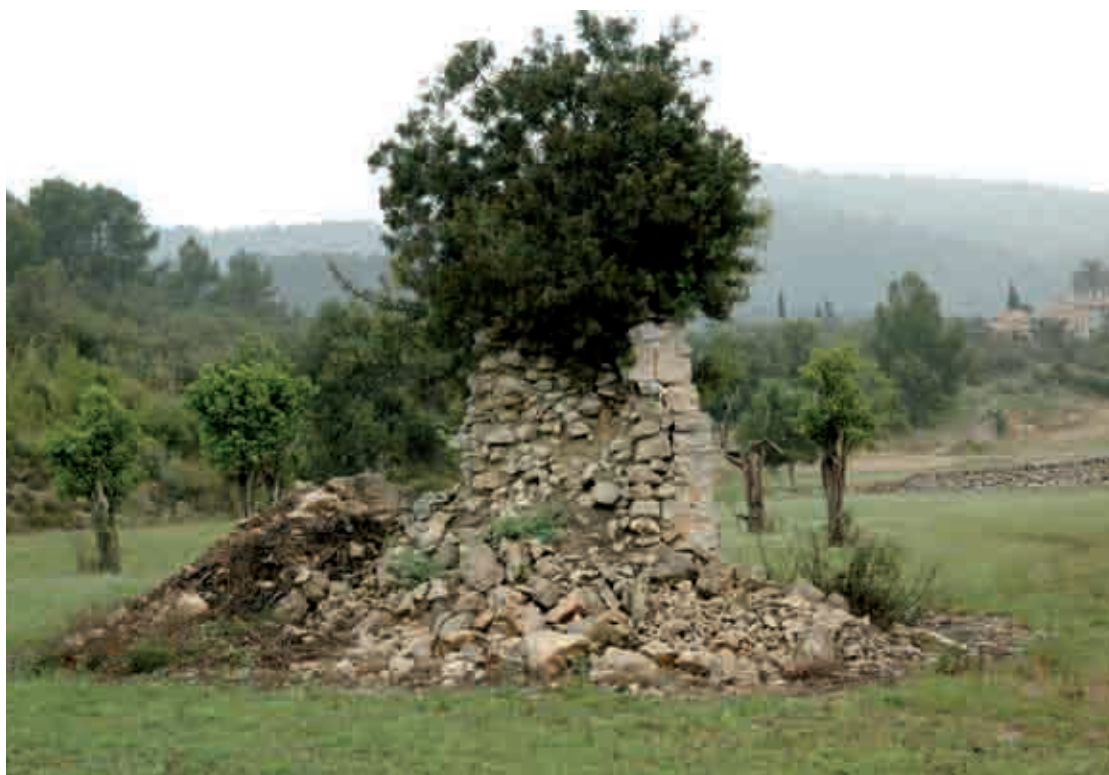
Figura 148. Estado de conservación deficiente del Pou de sa Vinya.
